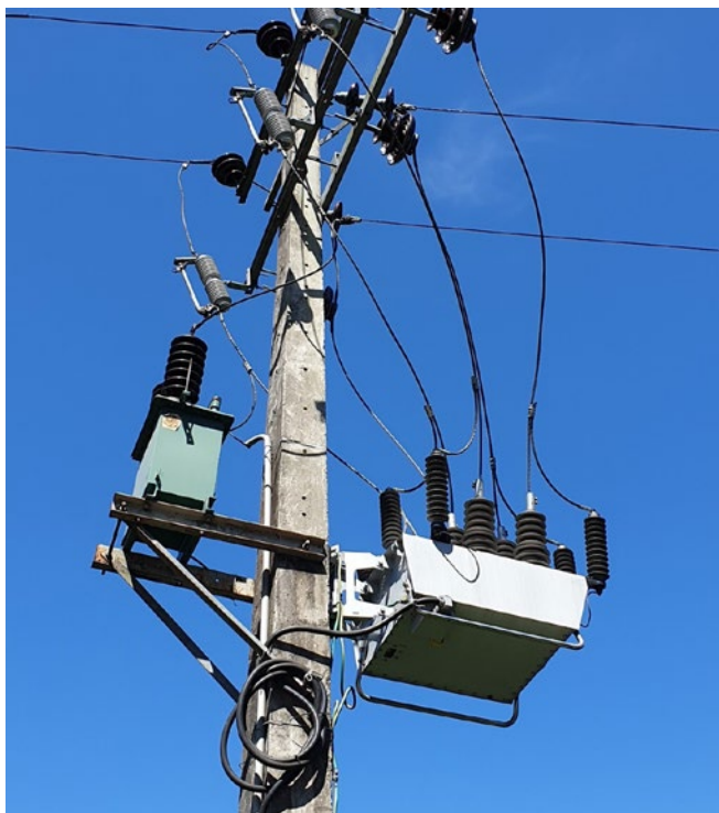
Hình 2 – Biến áp cấp nguồn dùng điện áp dây với sơ cấp được bảo vệ bằng FCO. Kế bên là Recloser OSM38 của NOJA Power.
