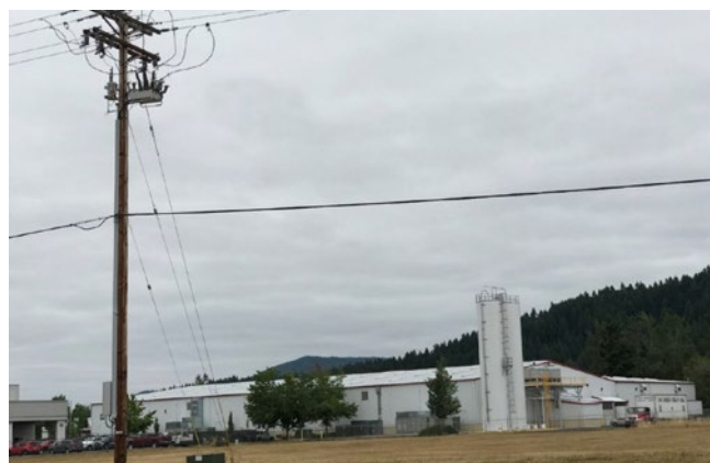
Hình 8 – Một vị trí lắp đặt điển hình recloser OSM của NOJA Power trên lưới EPUD, Eugene Oregon USA.
